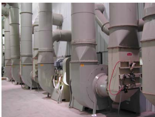
" Banjo 2 " dans une salle de ventilateurs.
