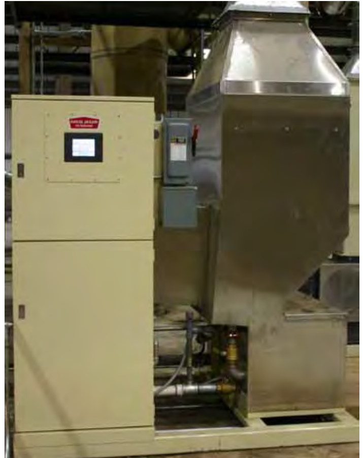
A King Mesa Humidaire Unit.
